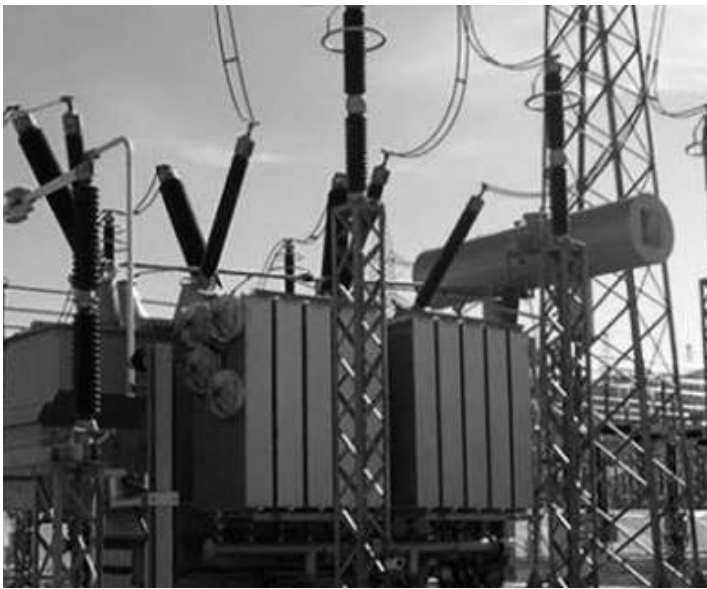
50 transformateurs électriques programmés, outre la réalisation d'un
